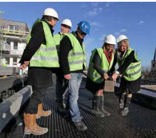
Het aanbrengen van dakbegroeiing door de wethouders Nieske Ketelaar en Marjan van der Aart, Rob Steltenpöhl, technisch adviseur Optigroen, architect Bart Mispelblom Beyer en Klaas Wiersma, directeur FrisiaBergum.
